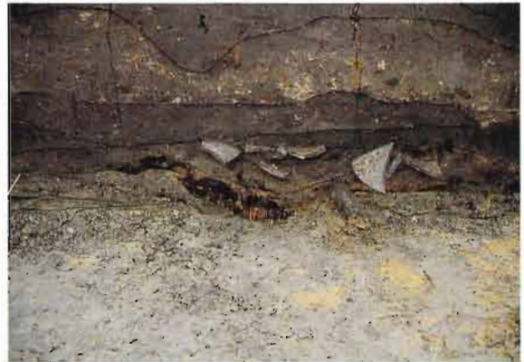
倒壊した柱材(pp2)〈01〉
