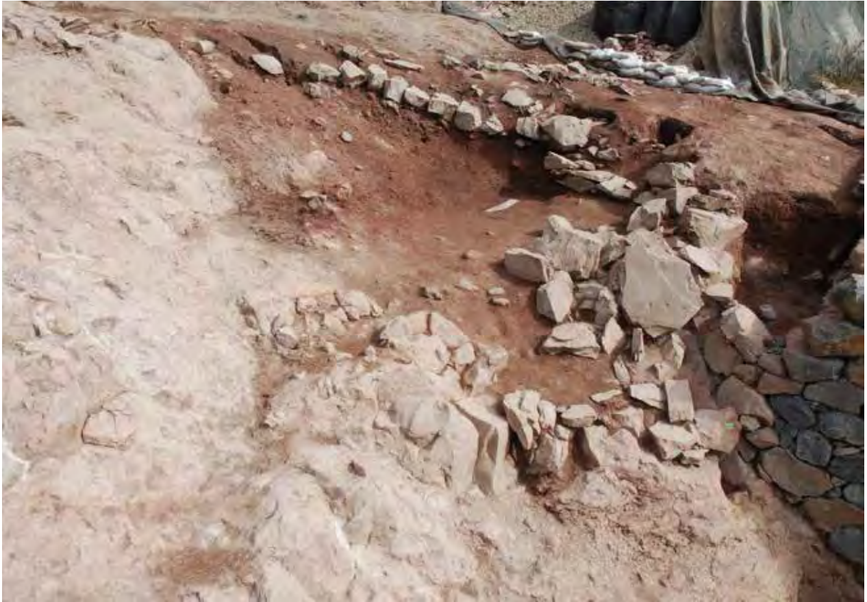
40- 1 甕城石積み崩落状況（北西から）
