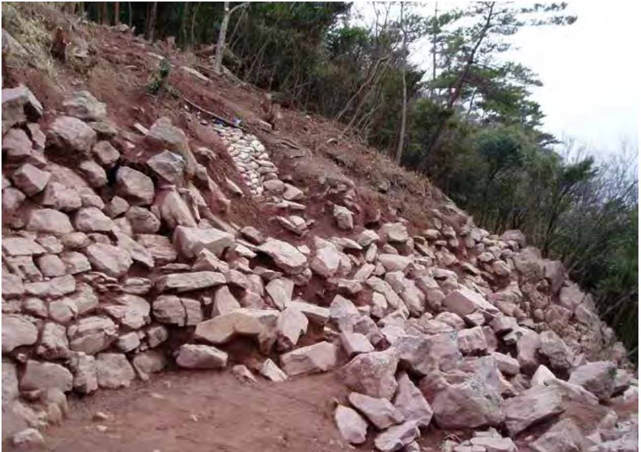
4-2 高石垣南側崩落状況（北東から 平成19年度）
