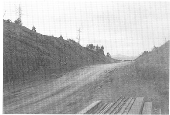
図12 工事中の近畿自動車伊勢線における黒色片岩の露頭・玉城町勝田南方(1991年12月撮影)
