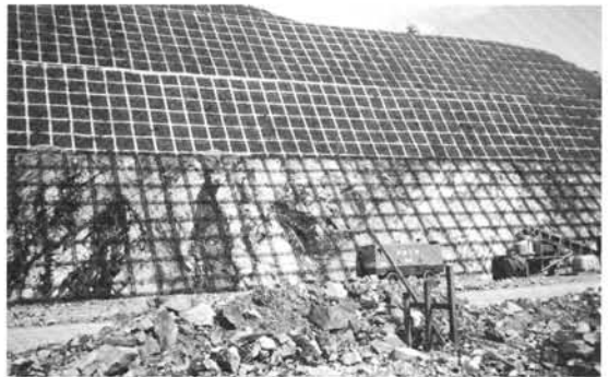
図5. 逆断層による破碎帯—大阿坂町岩倉(90.1.2)
