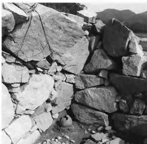
写真45 石室南東隅部角欠き状況（北西から）
