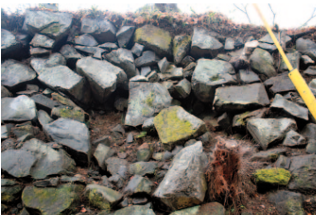
写真11 9面築石欠落部2
