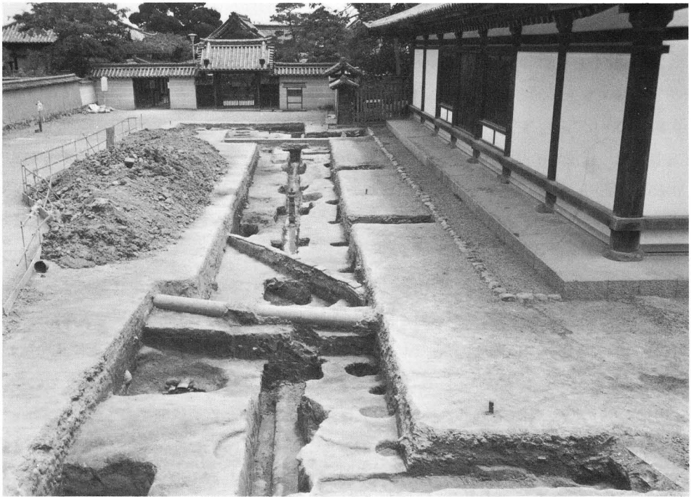
第49図 東院伝法堂北側の調査地全景(上・東から，下・西から)217トレンチ
