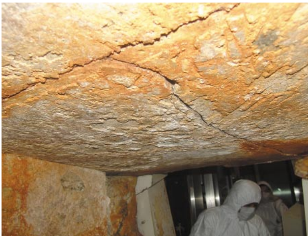
高松塚石室の石材の劣化
