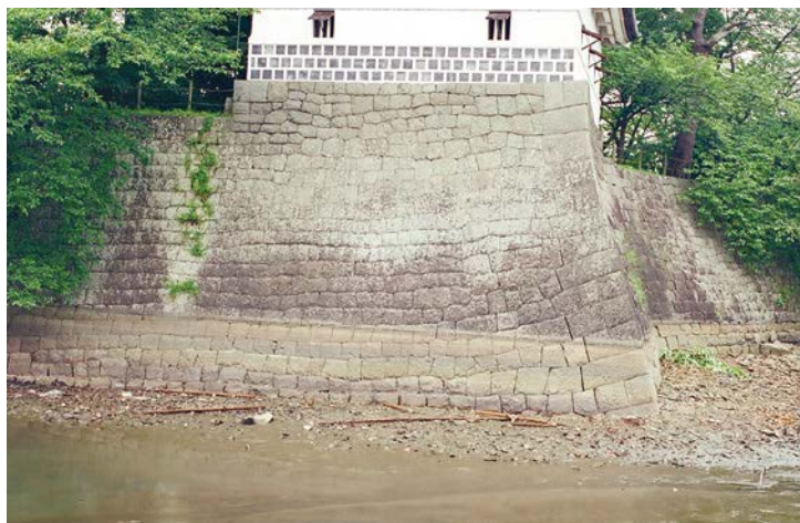
旧二の丸隅櫓南西面下 石垣変形② (G面：南西から)
