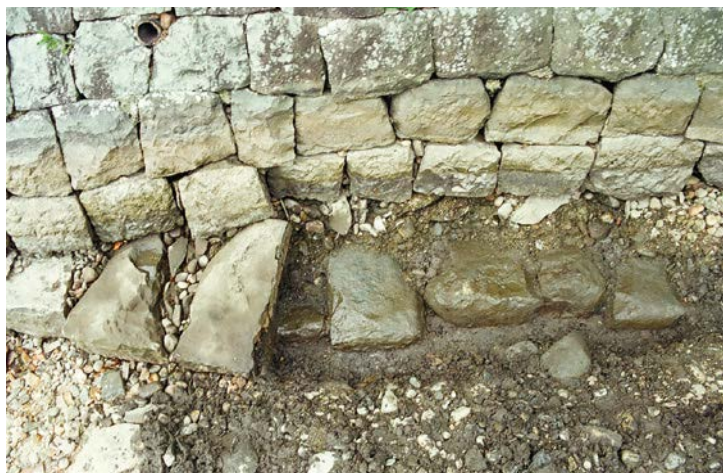
石垣下端の変形と土管埋設 (E面：西から)
