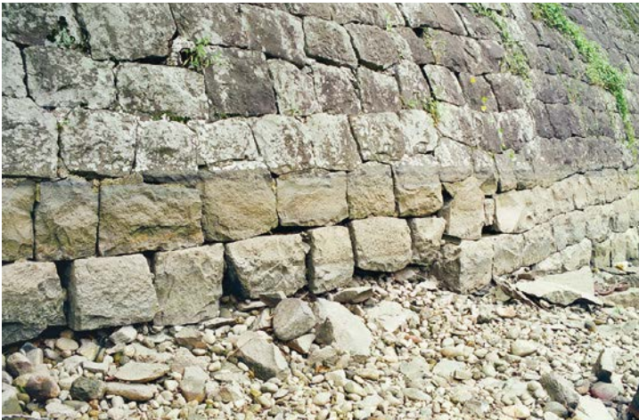
Eトレンチ東端 石垣下端の変形 (E面：南西から)
