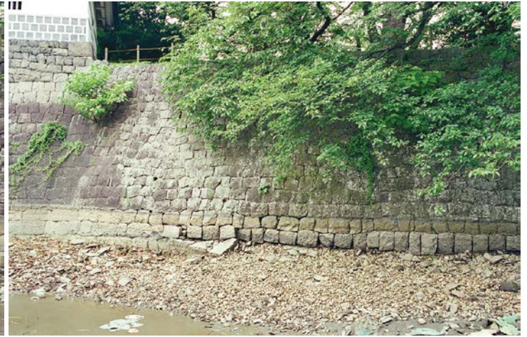
Eトレンチ西端 石垣下端の変形 (E面：南から)
