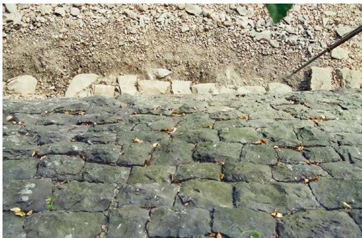
石垣下端変形①と上部積み直し部 (E面：西端, 南上から)
