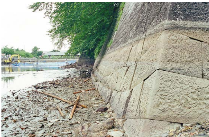
旧二の丸隅櫓南西面下 石垣変形②下端拡大 (G面：南東から)
