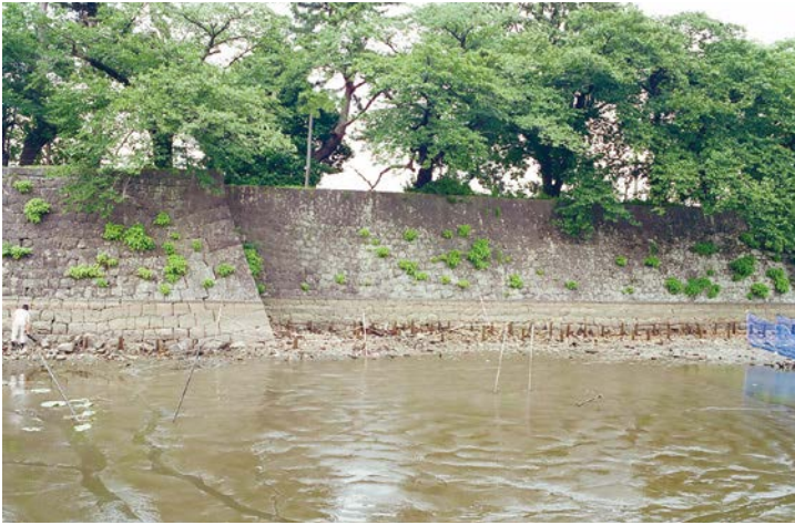
北側折南脇 石垣補強③ (I面：南西から)
