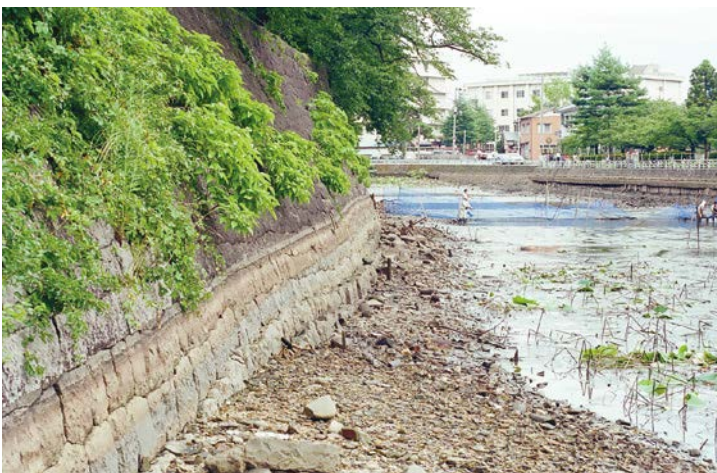
三階櫓南西面下 石垣変形③ (K面：北西から)
