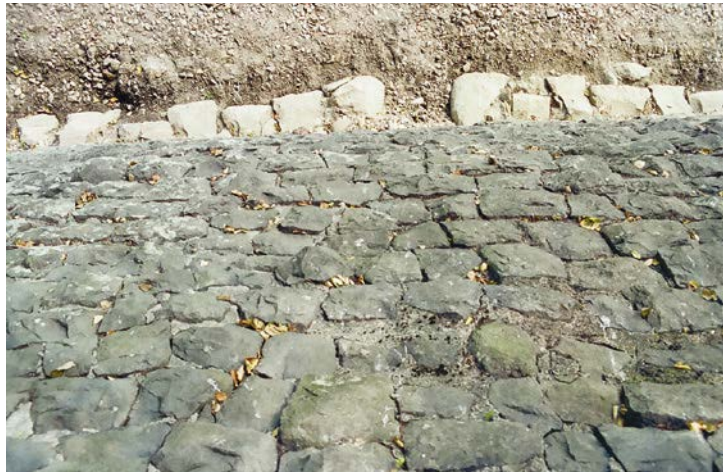
石垣下端変形①と上部積み直し部 (E面：中央, 南上から)
