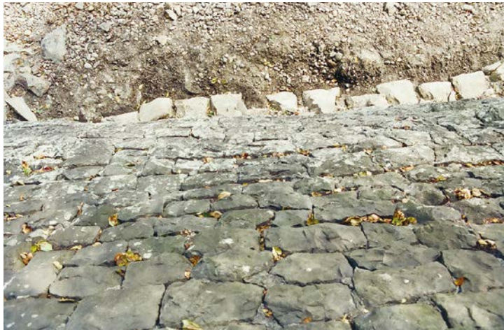
石垣下端変形①と上部積み直し部 (E面：東端, 南上から)
