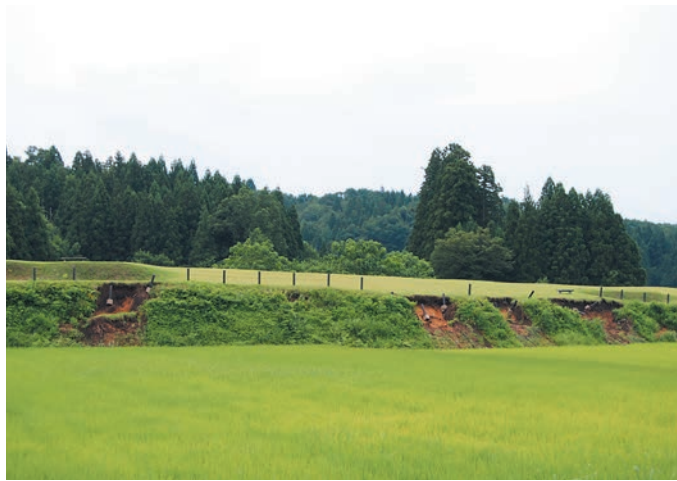
丸山遺跡 被害状況近景（北から）
