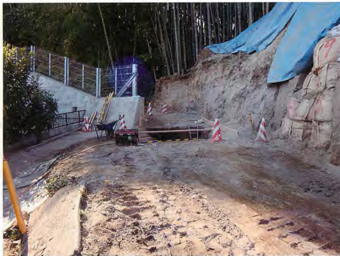
発見されたときのようす 天井部が陥没して発見された横穴墓
