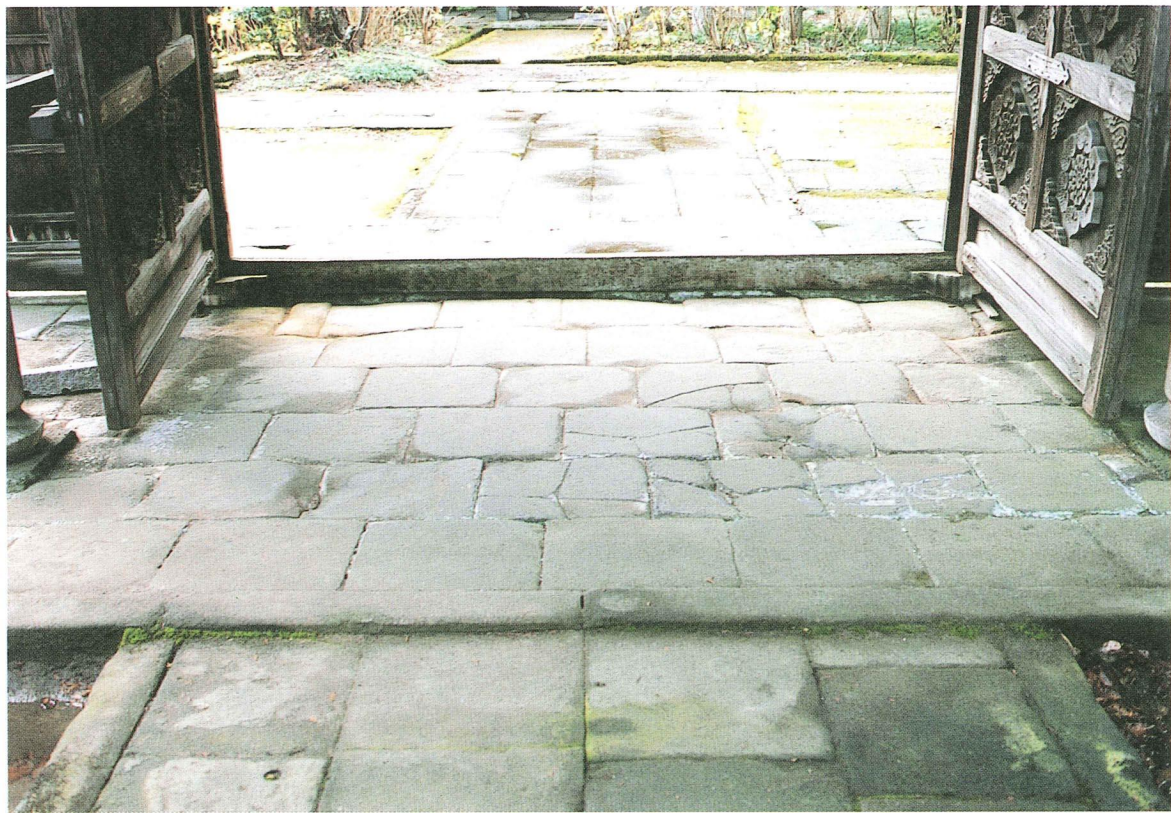
三代廟門内石敷(破損)
