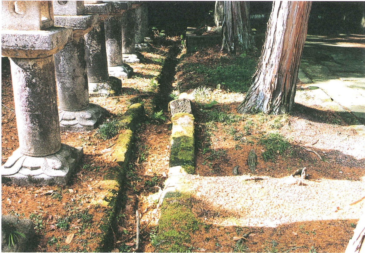
木の根による崩壊(三代廟所北側)
