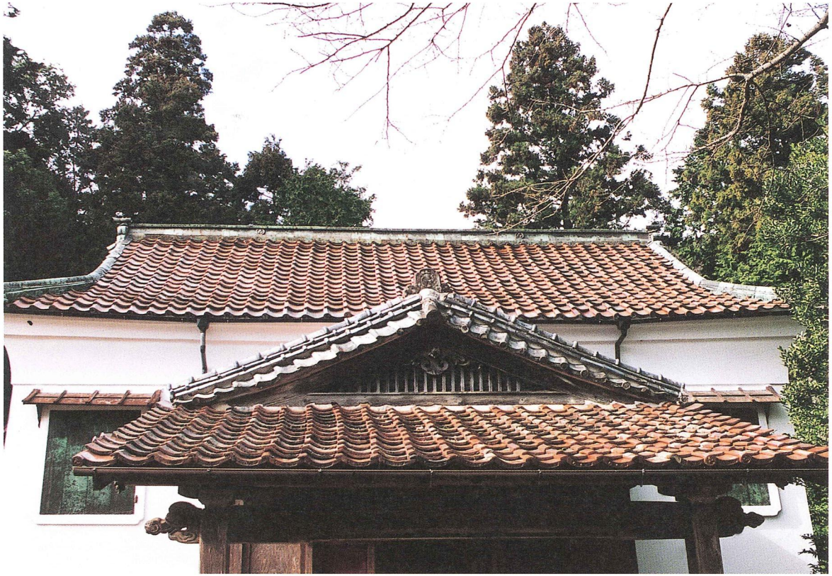
御霊屋屋根(陥没あり)
