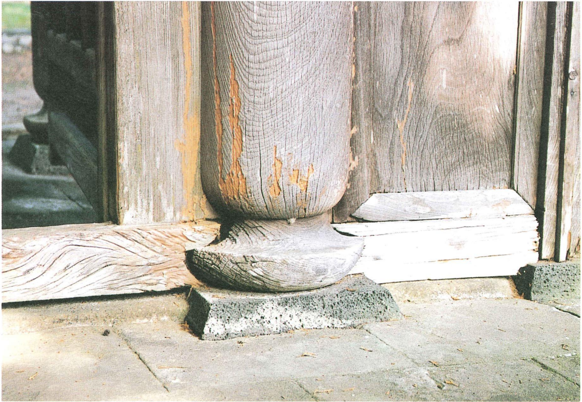
九代廟門柱(腐朽)
