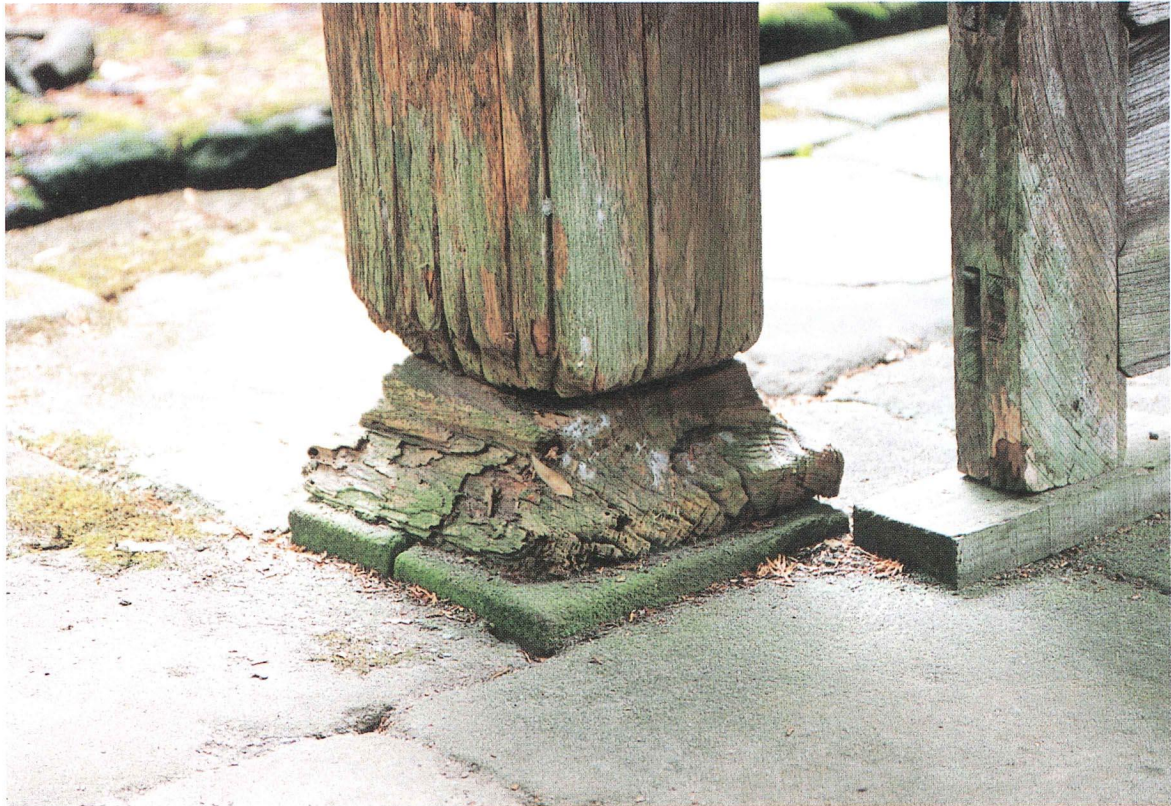
二代廟門柱足元(腐朽)
