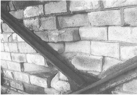
写真-214 煉瓦劣化状況
