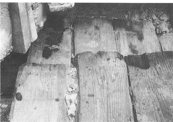
写真-189 鑄台床面の焦げ跡
