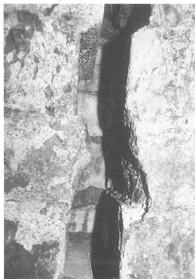
写真-105 煙突内部亀裂補修前
