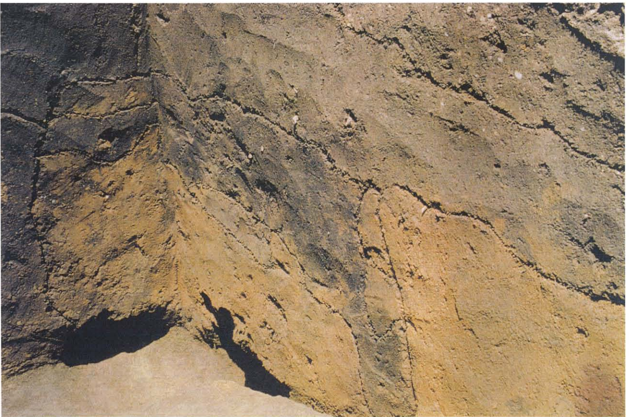
地下式坑（SK-01）の天井部の崩落状況（テストトレンチ北側面〈右〉と西側面〈左〉）
