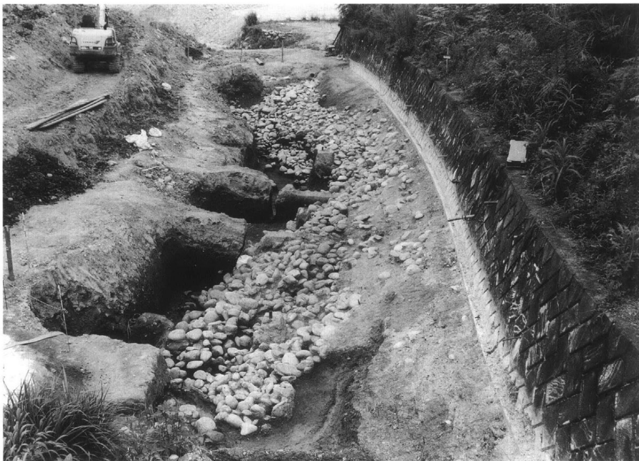
墳丘北側葺石崩落状況（西から）
