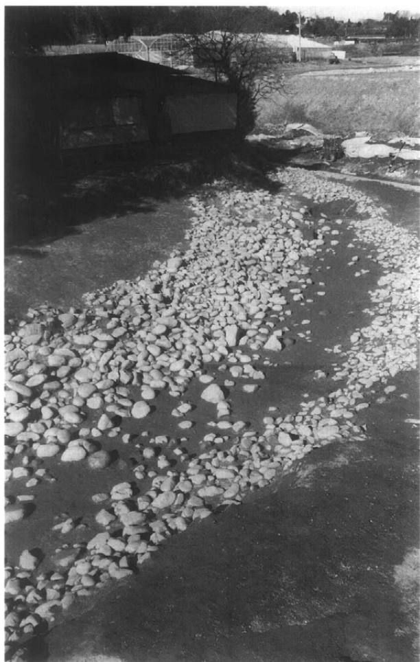
後円部南東側葺石崩落状況①（南から）
