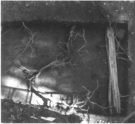
31 3-1区桜の根、電気ケーブルの状況
