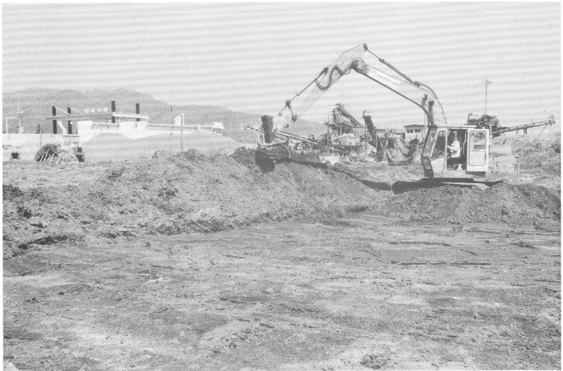
写真3 重機による表土除去（千曲川洪水による土砂が堆積している）
