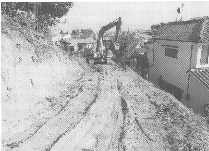
写真1 破壊現場（墳丘西側、北から）
