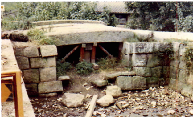
昭和 51.9.27 (1976) 重要文化財等保存整備工事⑦黒門石橋架替工事 着工前
