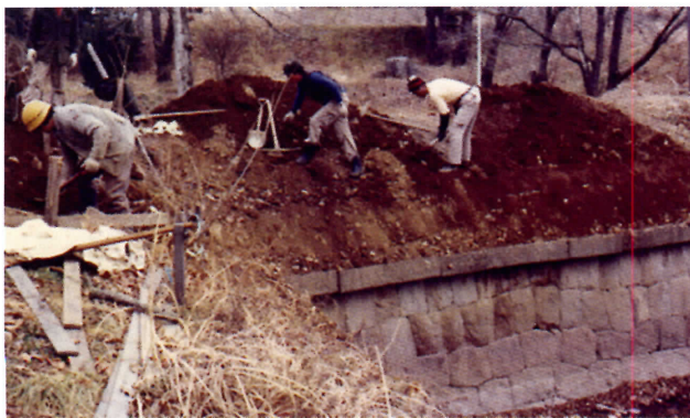
昭和 51 (1976) 国補重要文化財等保存整備工事 ④通用門土壘土盛工事
