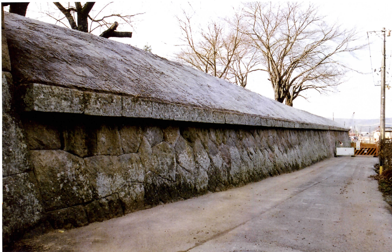
黒門西側石垣解体修理後 石垣東側全景（北西より） H22.12撮影
