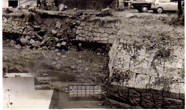
昭和 49.8.26 台風通過に伴う②崩壊ヶ所 (大手橋付近)
