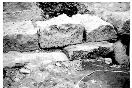
石組み暗渠 蓋石下面とその周囲が加工されている。（南より）
