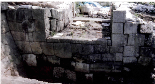
穴門排水口B面：修理前で石垣が孕んでいる。
