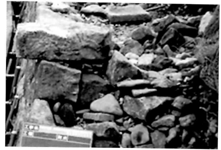
石積み工 裏込めの状況 控えの短い積み石に胴飼い石、尻飼 い石、尻押石を施工する。
