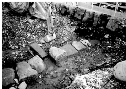
石組み暗渠内には泥土が充満
