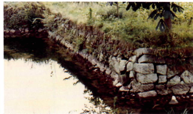
昭和 51 (1976) 国補重要文化財等保存整備工事 ③通用門石積工事着工前
