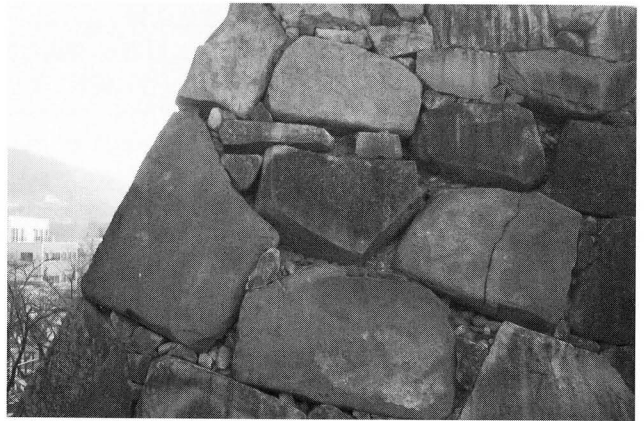
写真 14 薬剤塗布から7日後の状況
