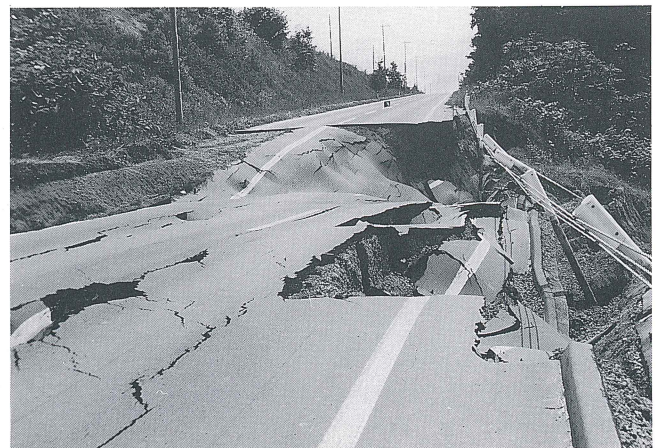
第19図 道路の損壊（字八束）
