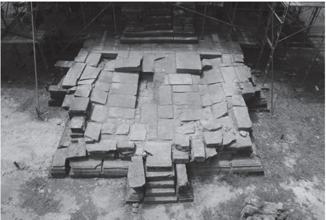
写真 -5 下成基壇表層敷石の沈下
