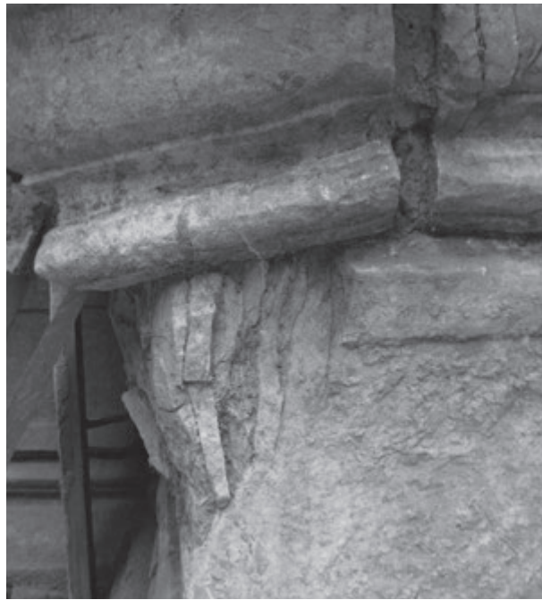
第39図 羽目石の破損状況
