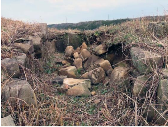
横穴式石室側壁が崩落
