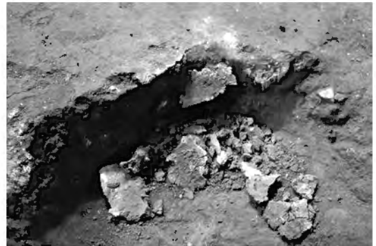
写真 8 塩類析出による崩落
