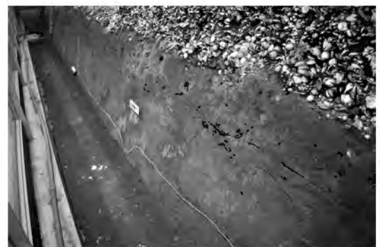
写真7 地衣類の発生状況②
