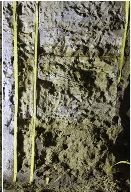
1-3. 転写作業後の左側壁の状況 （下部拡大）
