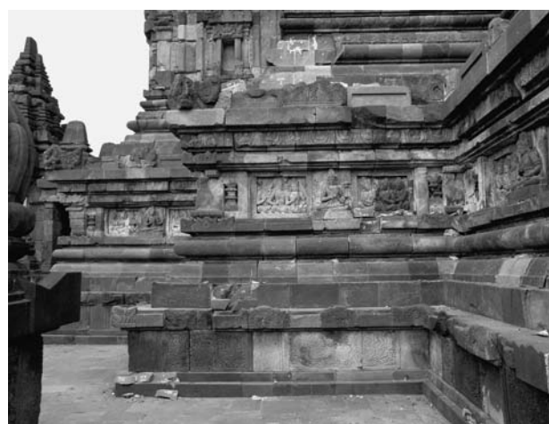
図14 シヴァ祠堂の身舎脚部の亀裂
