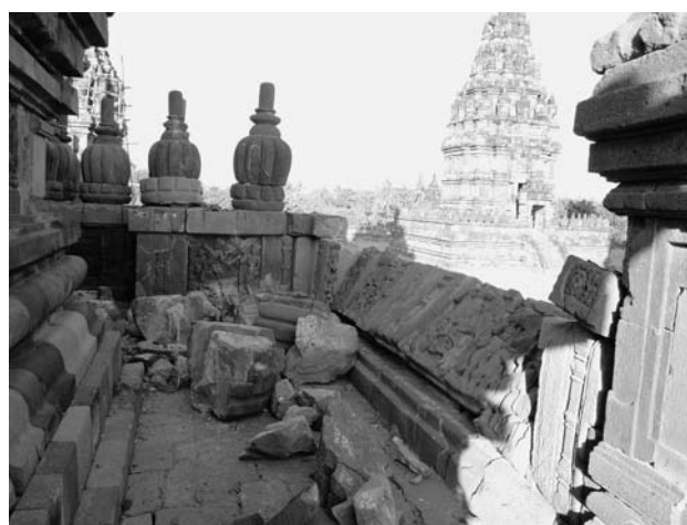
図13 基壇上部の被害状況
