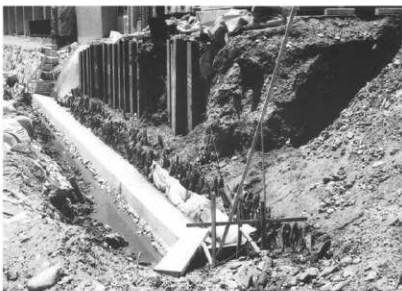
コンクリート布基礎打設状況 (遺構の杭列はこのまま埋め戻した)
