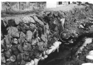
西面城内側石垣の破損状況
