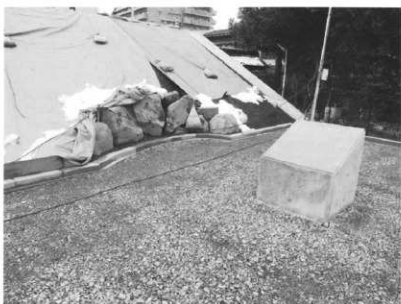
池状遺構挟り込み部の擁壁完了 地盤はカラー舗装の路床となる 碎石敷で、武家屋敷跡説明板軀 体はそこに置いた状態で据える
