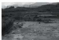
南北道路の全景（雨天後の水没）
