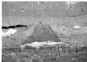
北壁洪水浸食状況、南から
