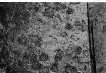
g. 同上・底面の状況
