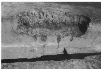
d. 同左・半割断面の状況
