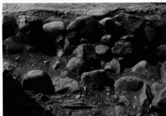
4. 玄室右壁破損部
