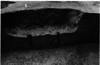
4 坑底部下部施設
