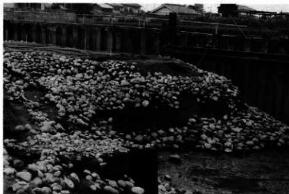
1 西辺第2張出部石垣崩落状態（北東より）
