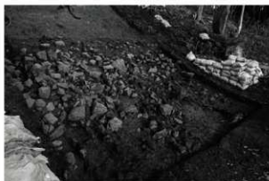
写真7 石垣 SW020102 崩落状況
