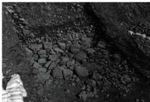
写真6 石垣 SW020101 崩落状況 (下層)
