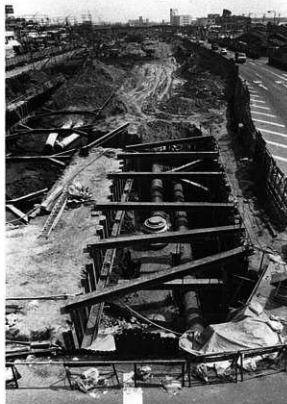
工業用水管接続部
