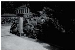
写真6 地震により崩壊した太鼓御門石垣
