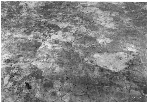
3区地震による地割れの状況
