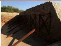
倒壊を防ぐために支柱が設置された壁 野口 淳 撮影
