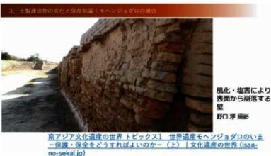
図22 モヘンジョダロの日干しレンガの崩落
