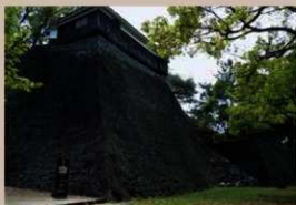
被災状況 H28(2016)4月
