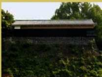
被災状況 H28(2016)4月
