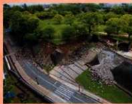
被災状況 H28(2016) 4月
