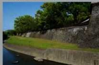
被災状況 H28(2016)4月
