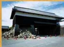
被災状況 H28(2016) 4月
