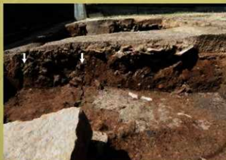
熊本地震の影響による地割れ (矢印部分)
