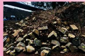
崩落した石材(令和4年1月)
