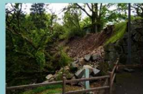
崩落状況(平成28年撮影)
