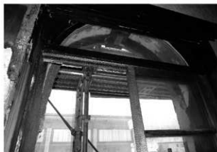
写真 3-27 当初と見られる窓枠（南面 2階・西側）
