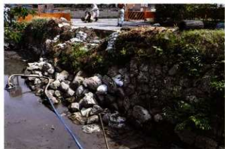
①外側 1-1 石垣 石垣崩壊状況 (南西から)
