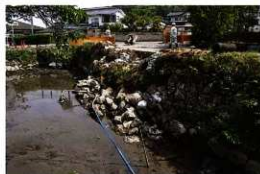
石垣崩壊状況（南西より）
