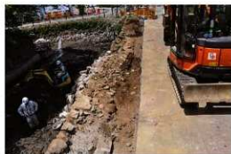
崩壊部裏込め検出（南より）
