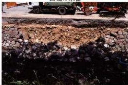
崩壊土除去状況
