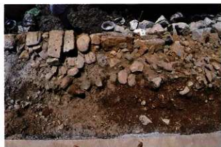
⑤崩壊部から南の石垣天端、裏込めにクラシャーランが入る (東から)
