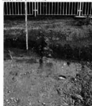
建物建設範囲堆積状況
