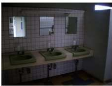
自動水栓化した手洗い
