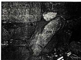
積み石(西壁7)のはらみ出し状況
