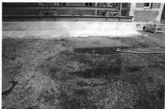
写真49 溢水状況(南より)
